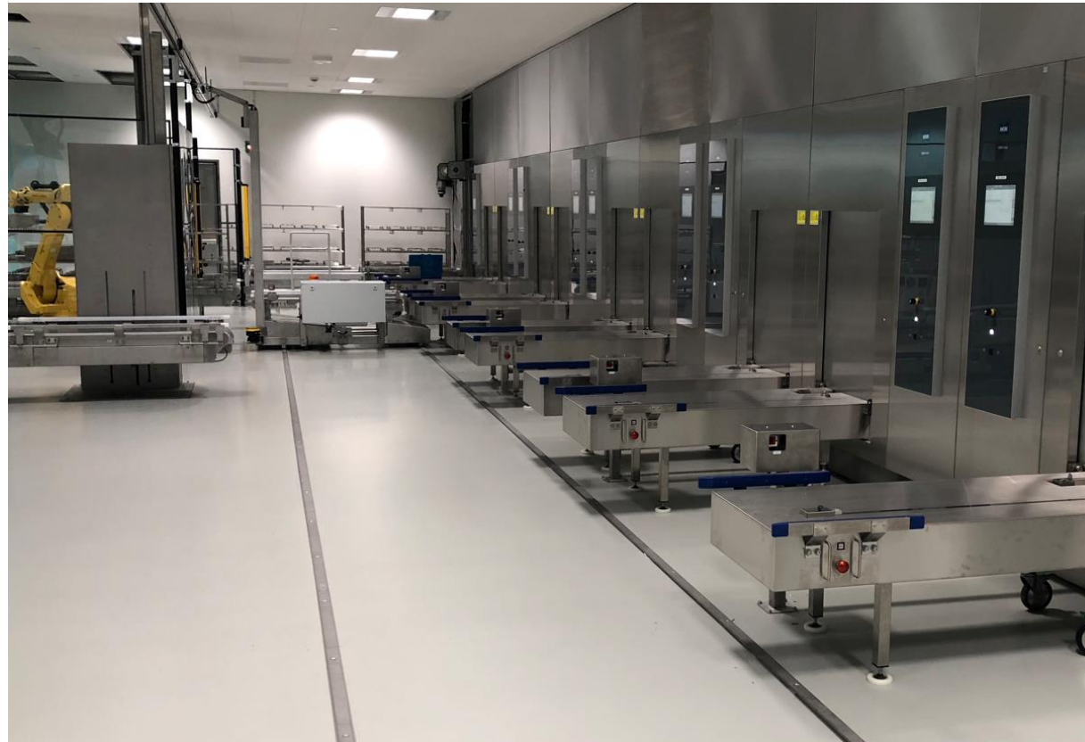
Eksempel på automatisk innlastanlegg for autoklaver
