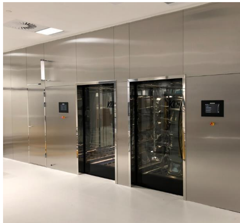
Eksempel på kabinettvaskemaskiner på rekke
